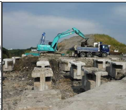
①-1 C・D・E工区掘削 E工区廃棄物土を掘削しています。
