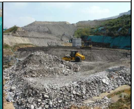
③ 選別土仮置・盛土工 B工区を埋め戻しています。
