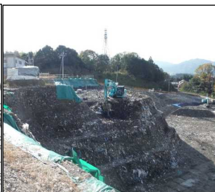
①-1 C・D・E工区掘削 E工区を掘削しています。
