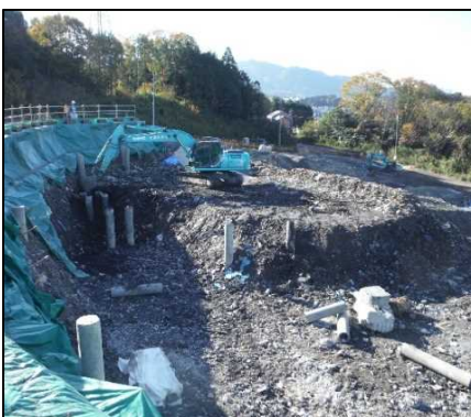
①-1 C・D・E工区掘削 既設杭を撤去しながらE工区を掘削しています。
