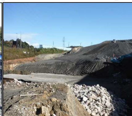
② 選別土仮置・埋戻し B工区を埋め戻しています。
