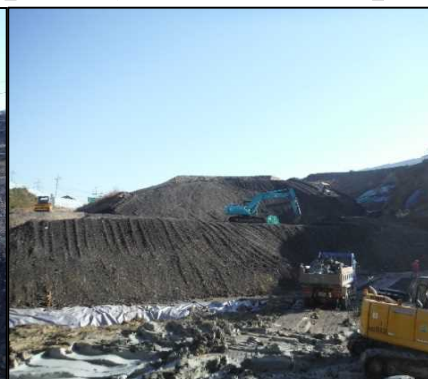
② 選別土仮置・盛土工 B工区を埋め戻しています。
