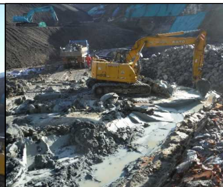
⑥ 浸透水貯留層工 浸透水貯留層を設置するために掘削しています。
