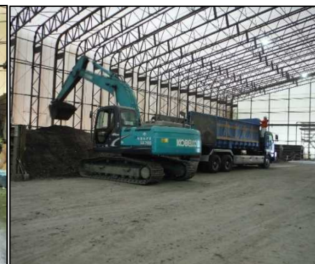
⑤ 選別処理工 不適合選別土を外部へ搬出しています。
