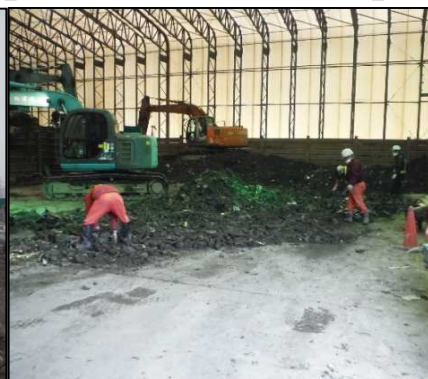
⑤ 選別処理工 雪のため選別建屋内で粗選別を行っています。
