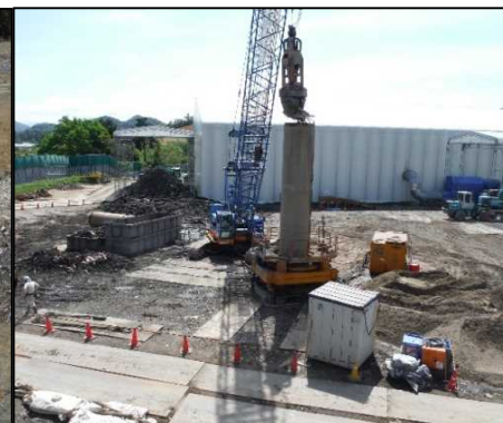
② 有害物土掘削 全巡回でC区画矢板部の掘削、置換を行っています。
