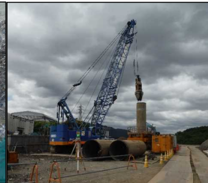
② 有害物土掘削工 全巡回でC区画矢板部の掘削、置換を行っています。
