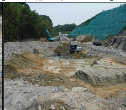
① 廃棄物土掘削工 C工区の地盤改良工基盤の整形をしています。
