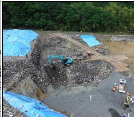
① 廃棄物土掘削工 E工区の廃棄物土を掘削しています。
