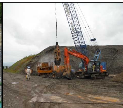
② 有害物土掘削工 全周回でFG区画の置換をしています。
