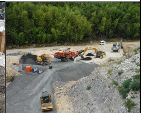
⑥ 底面・側面遮水工 CD工区底面遮水工を行っています。
