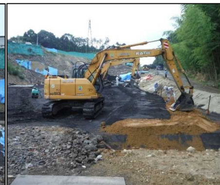
⑥ 底面・側面遮水工 CD工区側面遮水工を行っています。
