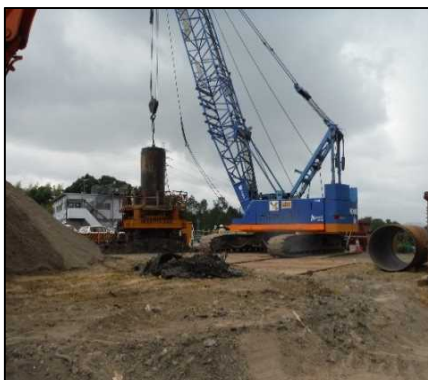
② 有害物掘削工 FG区画の置換杭完了後ケーシングを引き抜いています。
