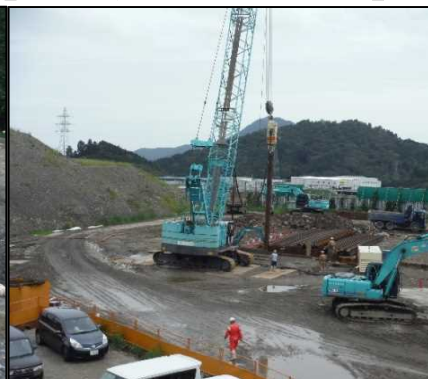
② 有害物掘削工 C区画の鋼矢板を打設しています。
