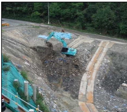
①-1 D・E工区廃棄物土掘削工 E工区廃棄物土を掘削しています。
