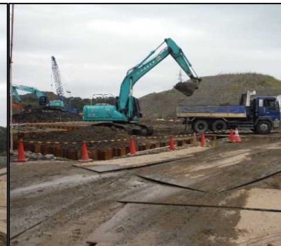
② 有害物掘削工 C区画の廃棄物土を掘削しています。
