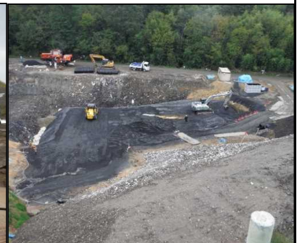
⑦ 底面・側面遮水工 DE工区底面遮水部基盤整備を行っています。
