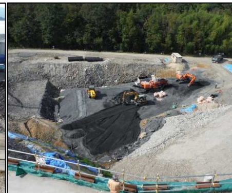
⑦ 底面・側面遮水工 DE工区底面遮水を行っています。
