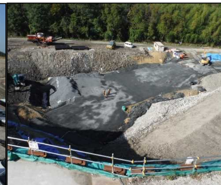
⑥ 底面・側面遮水工 DE工区の掘削が完了している部分の底面遮水完了しました。
