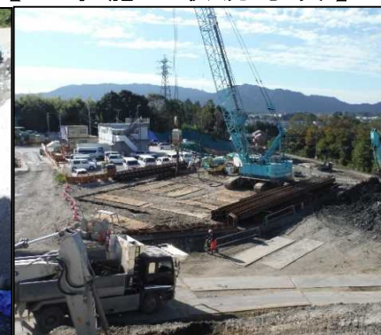
② 有害物掘削工 FG区画の鋼矢板を打設しています。
