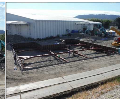
② 有害物掘削工 C区画の一段目支保工を架設しています。
