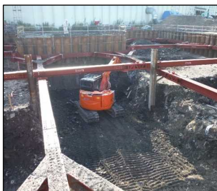
② 有害物掘削工 C区画の廃棄物土の掘削を行っています。
