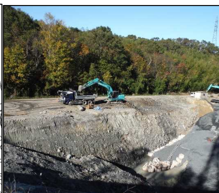
①-1 D・E工区掘削工 D工区西市道側の掘削を行っています。
