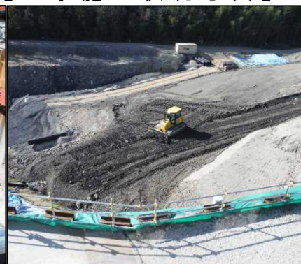
④ 選別土仮置・盛土工 DE工区の盛土を行っています。
