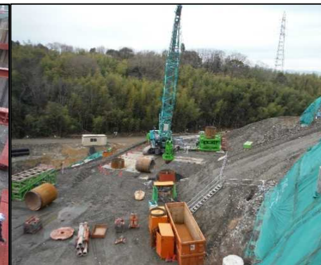
⑤ 底面・側面遮水工 全回転オールケーシング工法により底面遮水工を行っています。
