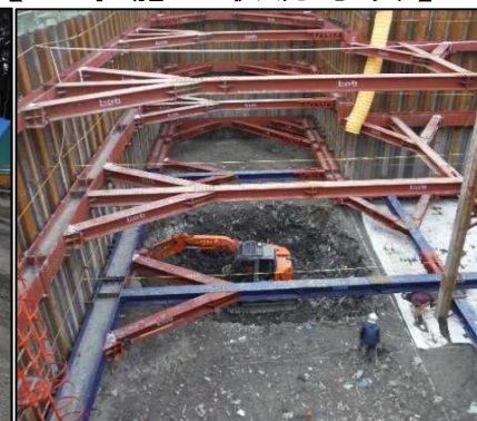
② 有害物掘削工 C区画の四次掘削を行っています。
