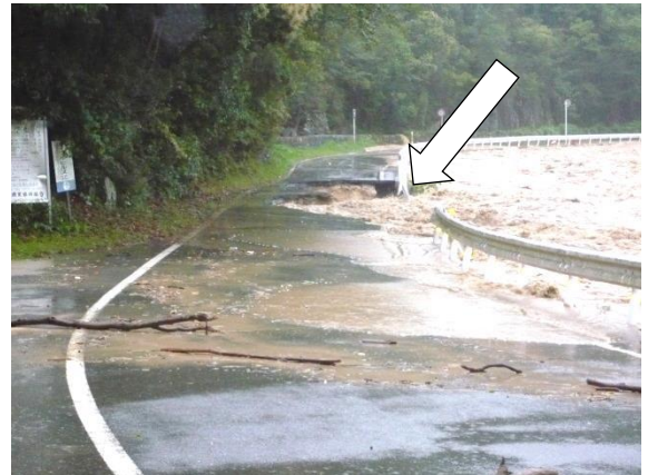
道路の陥没⇒、夜には気づきにくい
