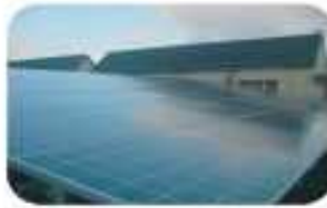
ソーラー発電 (10KW×4基)
