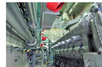
高圧注水系エリアの機器
