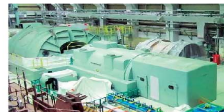
タービン・発電機
