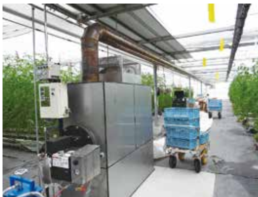
浅小井農園(株)の廃食油ボイラー 【近江八幡市: 発熱量80,000kcal/h】
