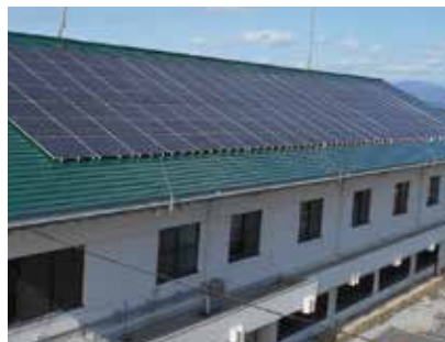
揚水機場の屋根を利用した太陽光発電 (彦根市 彦根中部用水土地改良区)
