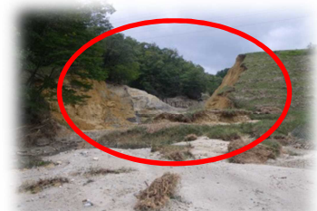
H29 台風 21 号豪雨災害により堤体決壊
