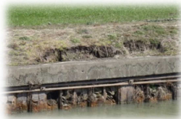
干拓地承水溝の鋼矢板の腐食
