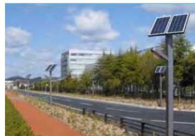
ソーラーLED照明
