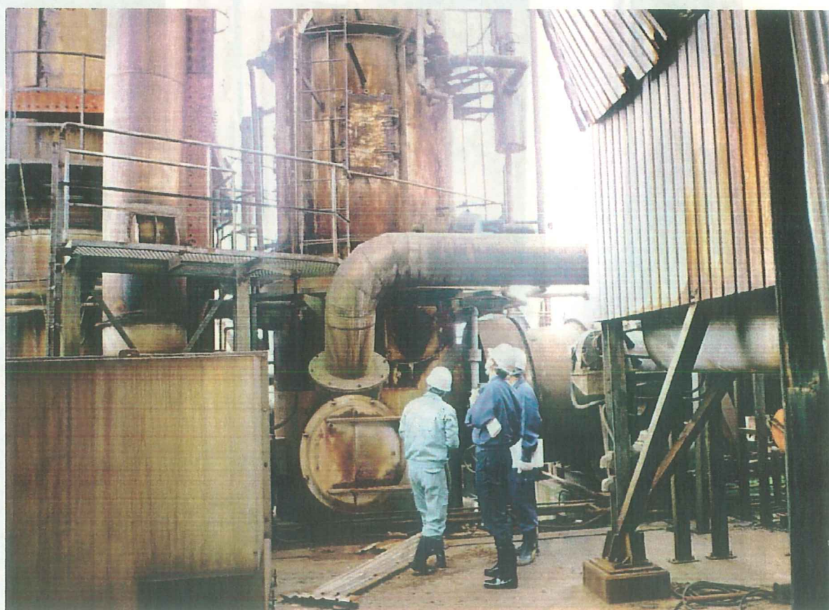
燃烧炉全景/腐食状况
