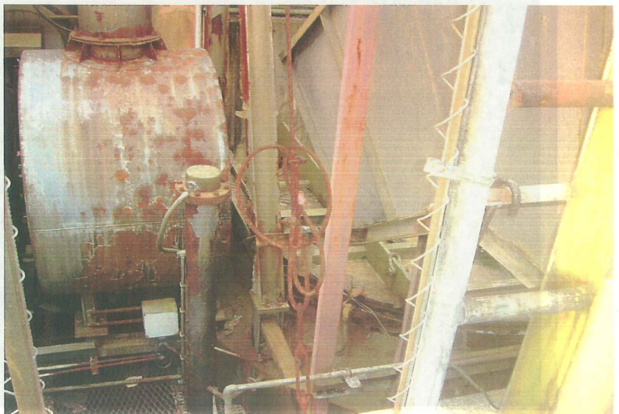
ロータリーキルン/腐食状況
