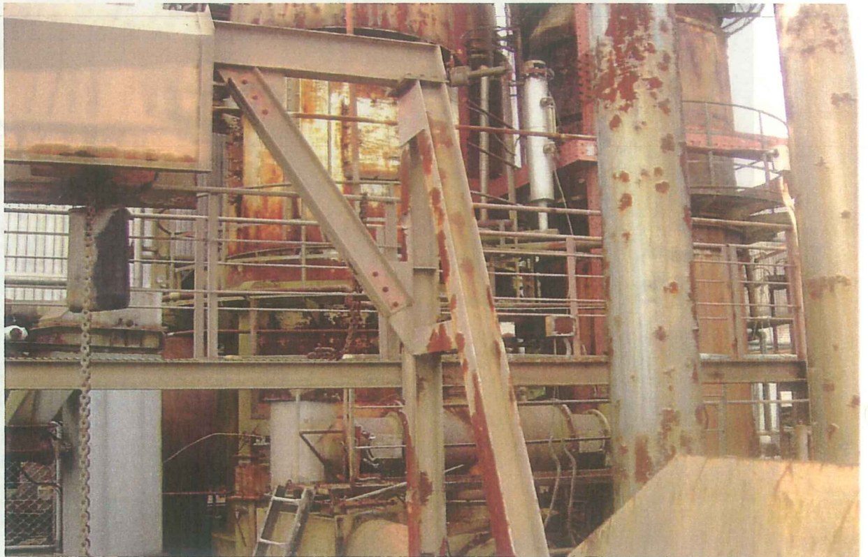
ロータリーキルン/腐食状況
