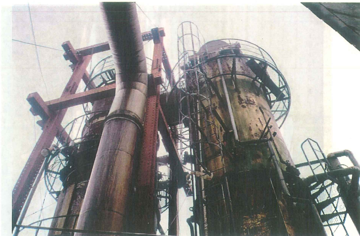
燃烧炉全景/腐食状况
