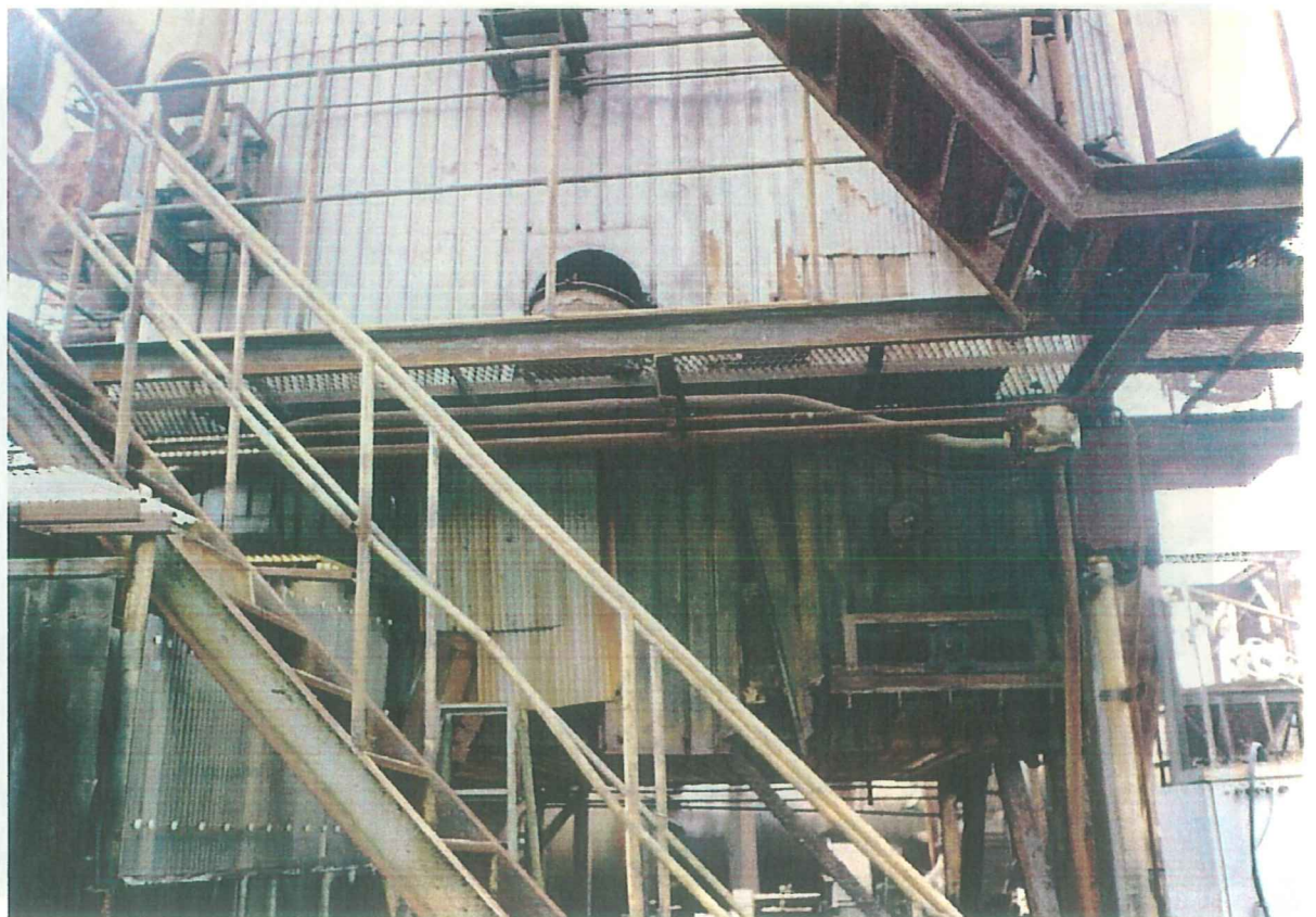
③集塵機上部
