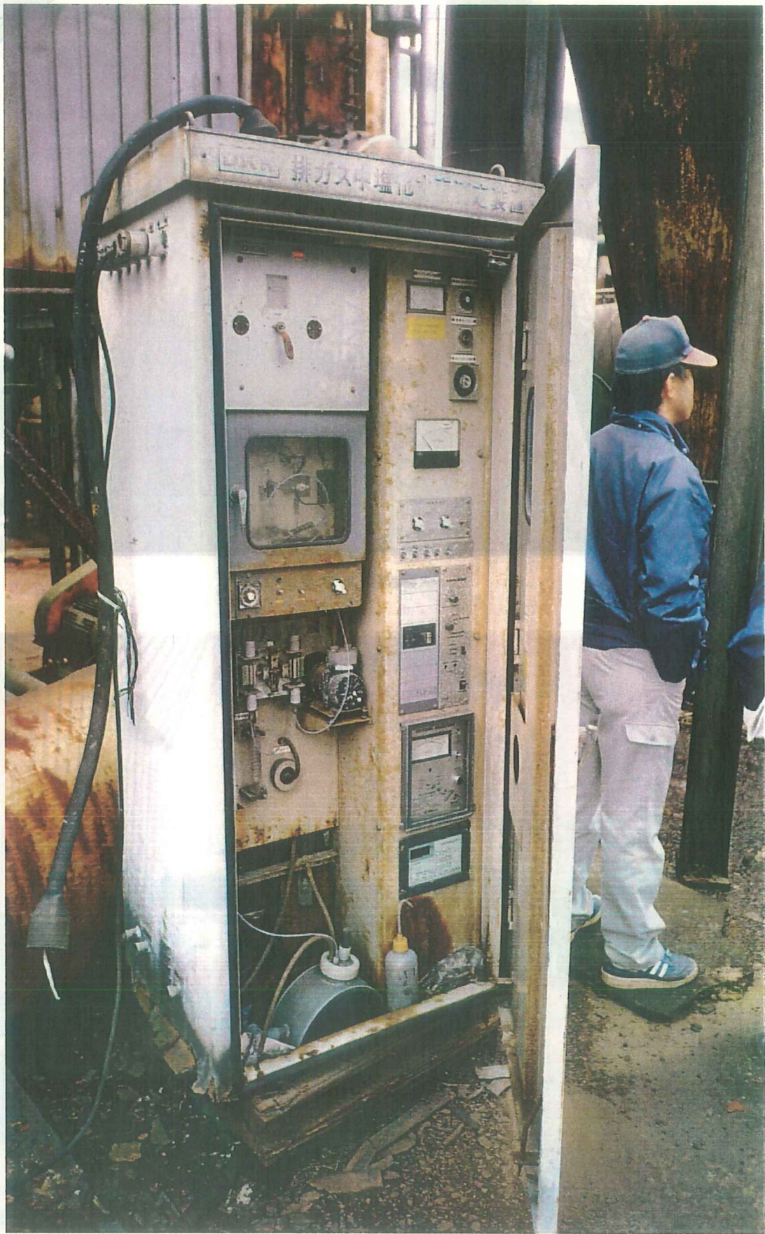
パネルの腐食状況
