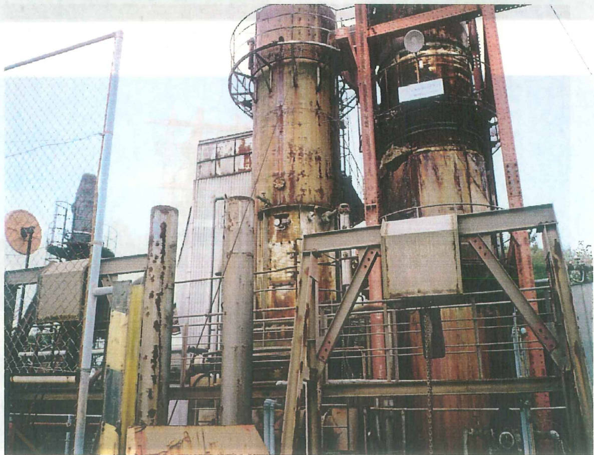
燃烧炉全景/腐食状况
