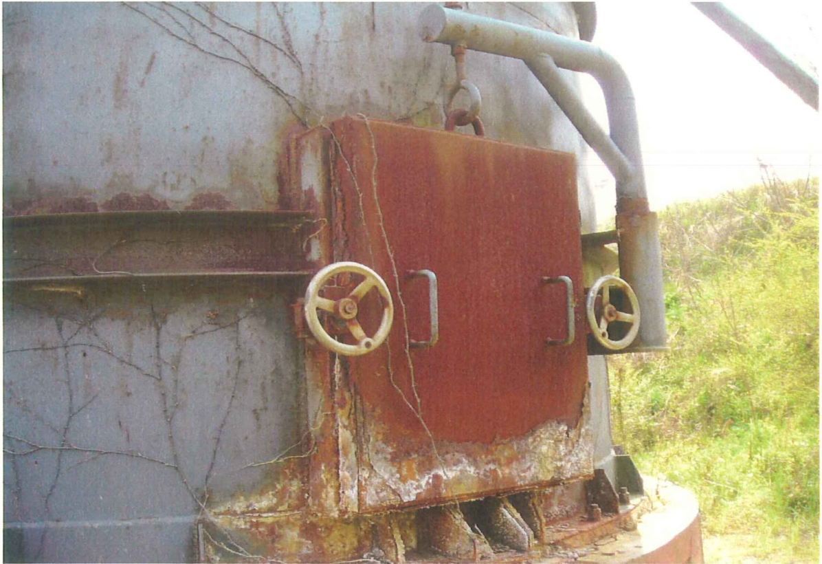
② 煙突下部（点検口） 点検口腐食
