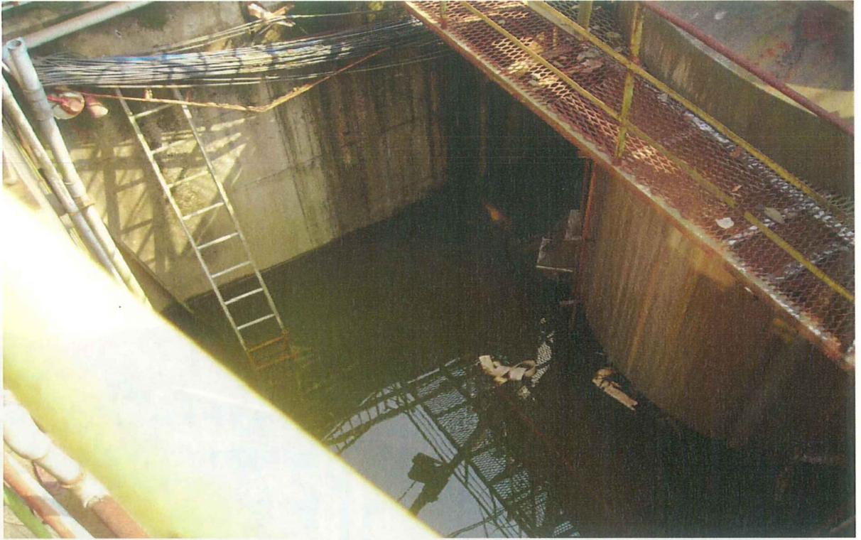
⑦燒却炉乾留炉水没部
