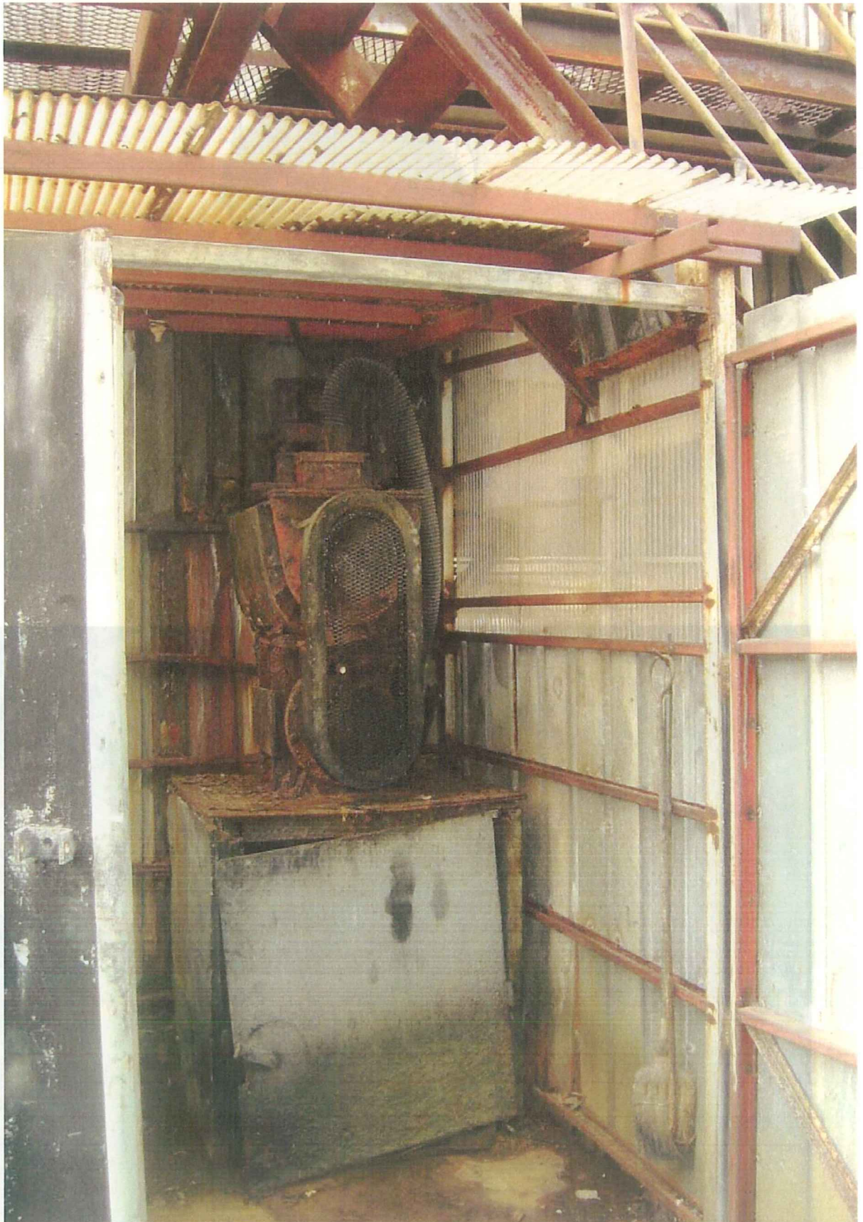
集塵機下部と煙突の接合部の脱落状況
