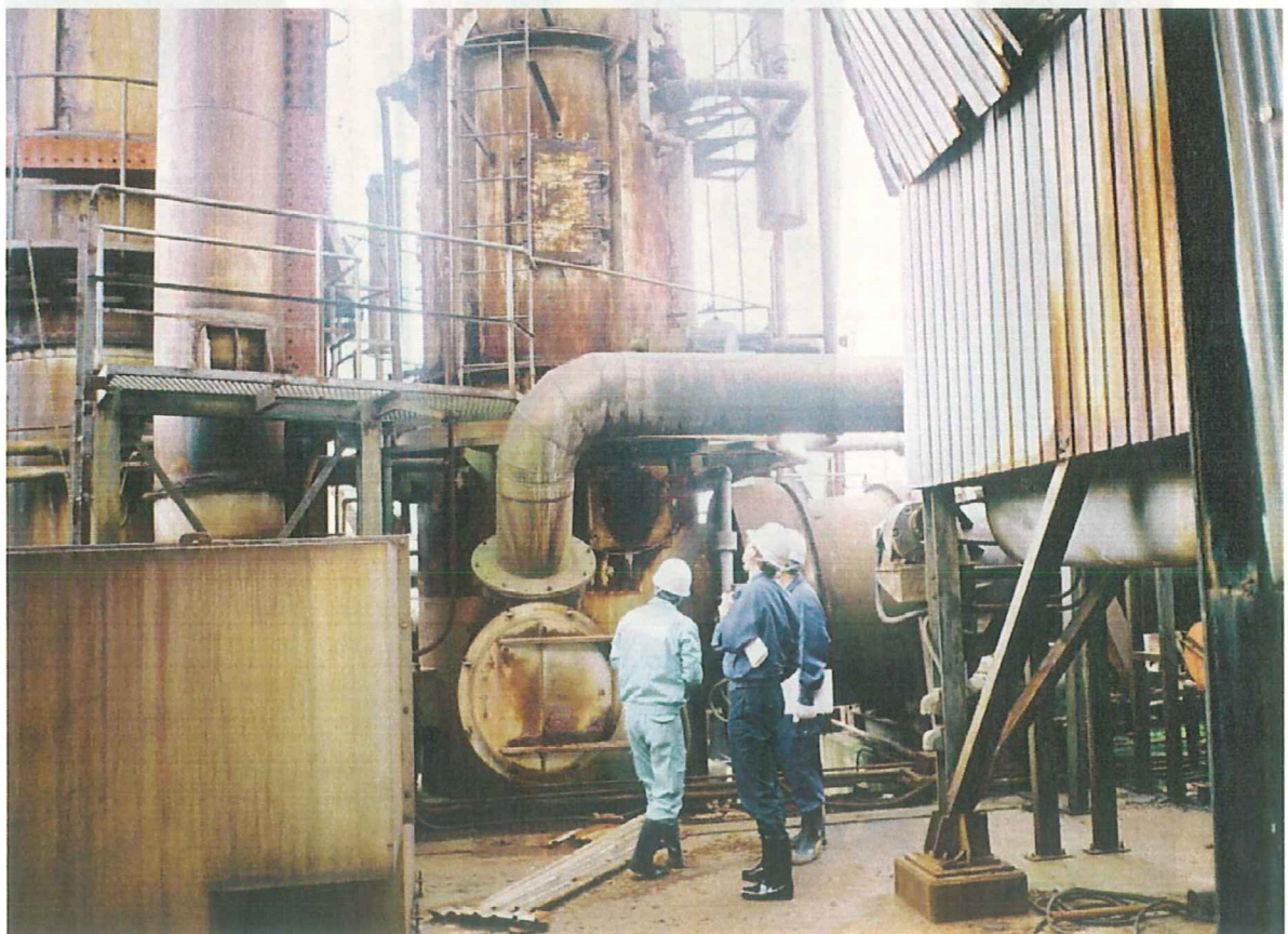
燃烧炉全景/腐食状况
