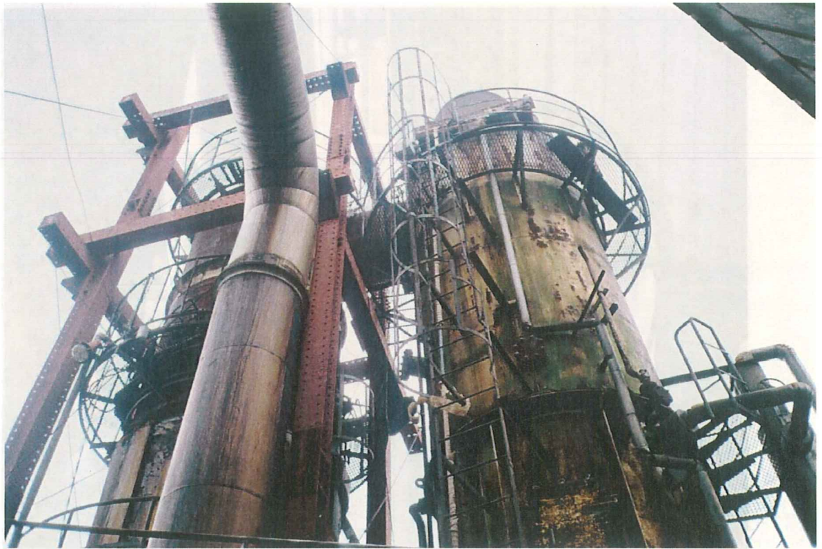
燃烧炉全景/腐食状况
