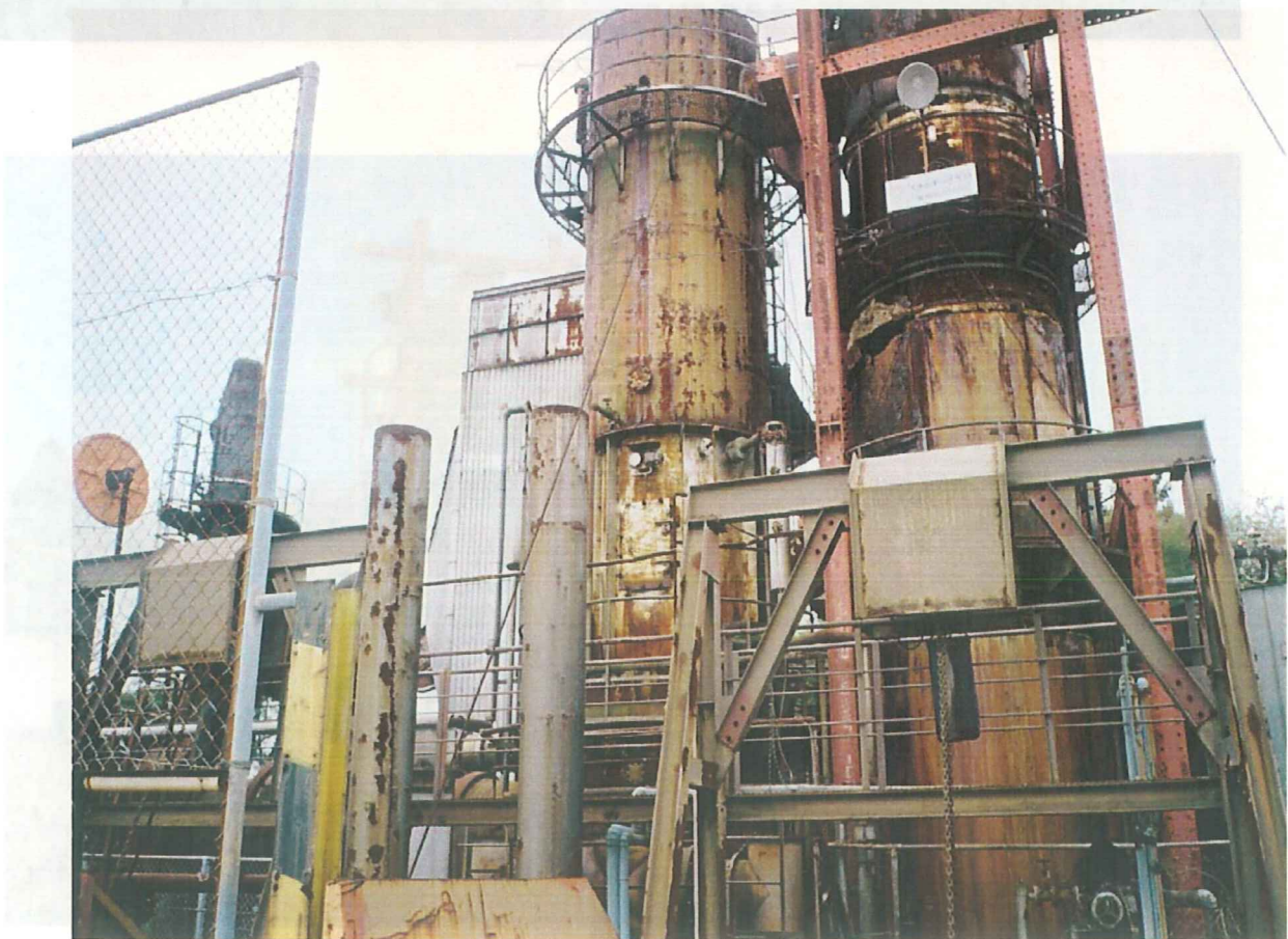
燃烧炉全景/腐食状況
