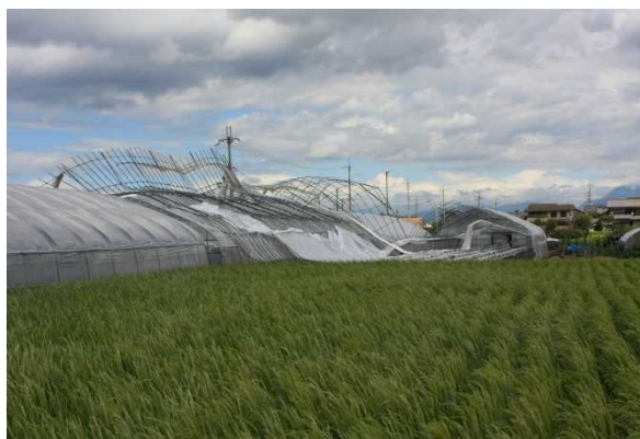
台風により全壊したパイプハウス
