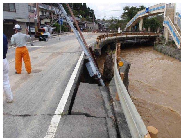
(写真4 国道307号被災直後の状況)
