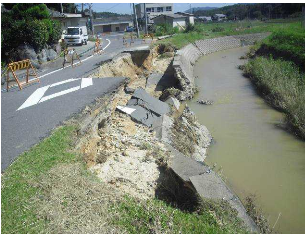
(写真-8 市道の被災状況)
