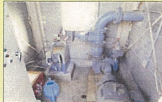
循環かんがい施設内部
