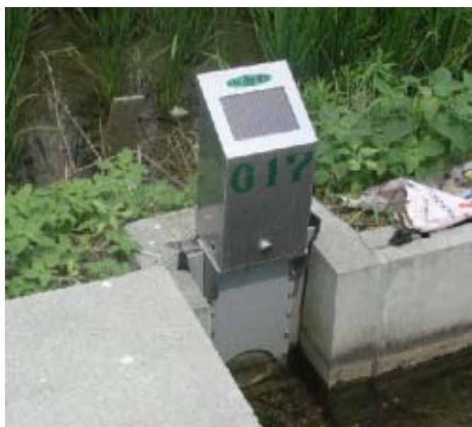
写真 - 7 開水路自動給水栓
