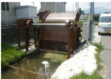
▲水位を検知して電動自動運転する除塵機（高島市）[提供：鴨川流域土地改良区]
