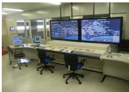
▲水管理システム操作卓（高島市） [提供：鴨川流域土地改良区]
