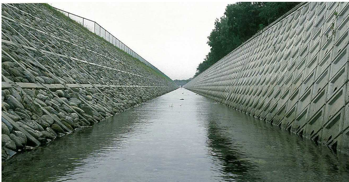
▲豊椋集水渠（東近江市）〔『愛知川土地改良区 50 周年記念写真集』より転載〕
