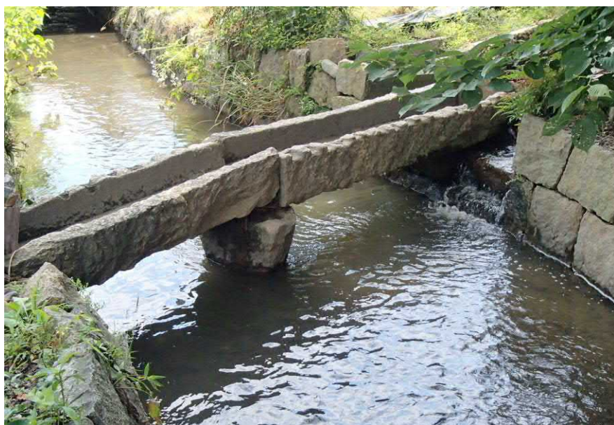
▲掛越樋（野洲市）[提供：滋賀県] 祇王井川の上を別の水路がまたいでいる
