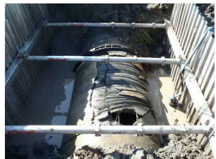
▲管水路の破損事故 [提供：滋賀県]
