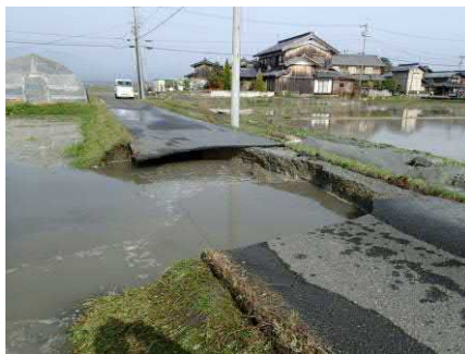
▲圧送管の破損による被害 [提供：滋賀県]
