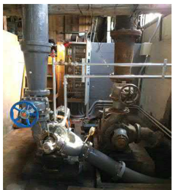
▲砂山池揚水機場内の現在の揚水ポンプ（豊郷町）[提供：犬上川沿岸土地改良区]
