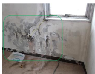
漏水跡・ひび割れ
