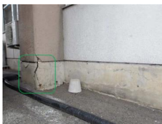
コンクリートの剥離
