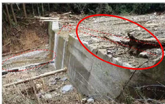
堰堤本体の広範囲にわたる欠損
