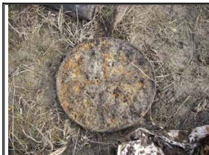
マンホールのふた
