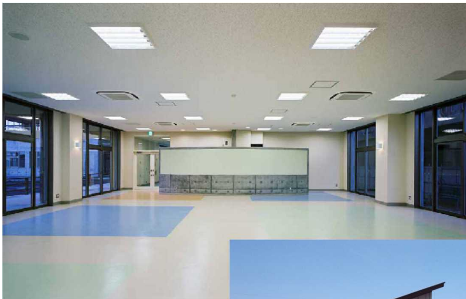
空調機（天井埋込型）
