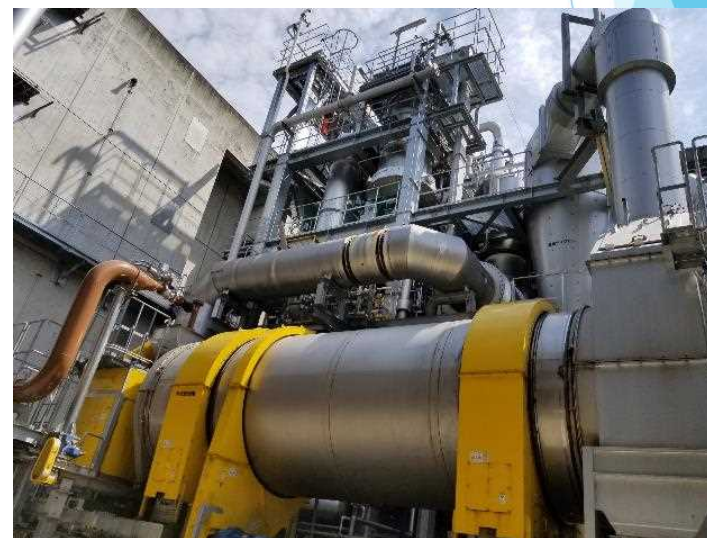
污泥燃料化施設（湖西浄化センター）
