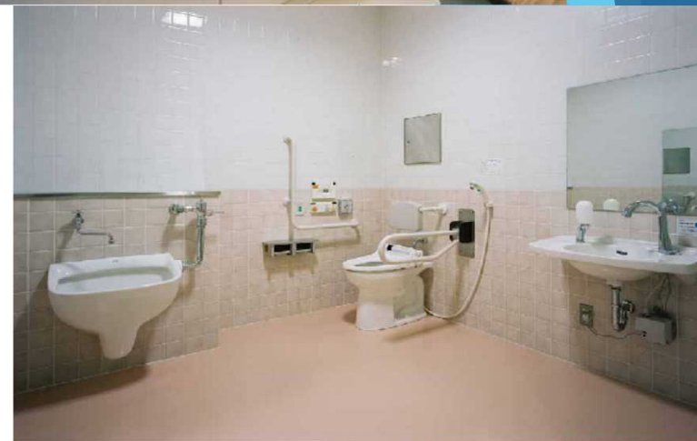
給排水衛生設備
