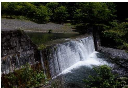
甲賀市土山町黒滝(堤体全体にひび割れ、天端部の欠損)
