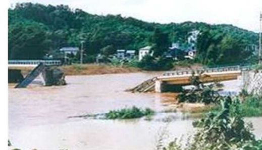
大戸川 1982 (S57)年8月出水被害写真 (石居橋)
