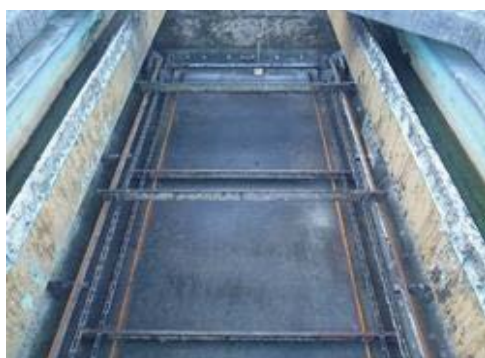
図2. 湖南中部浄化センター2系水処理施設(腐食)
