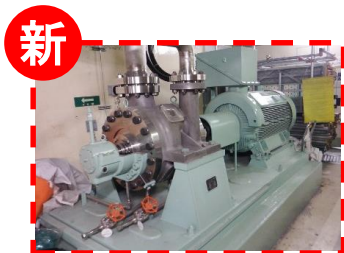
恒設代替低圧注水ポンプ 【1台/号機】
