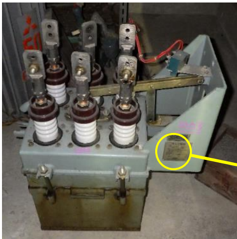
遮断器 (油入遮断器)
