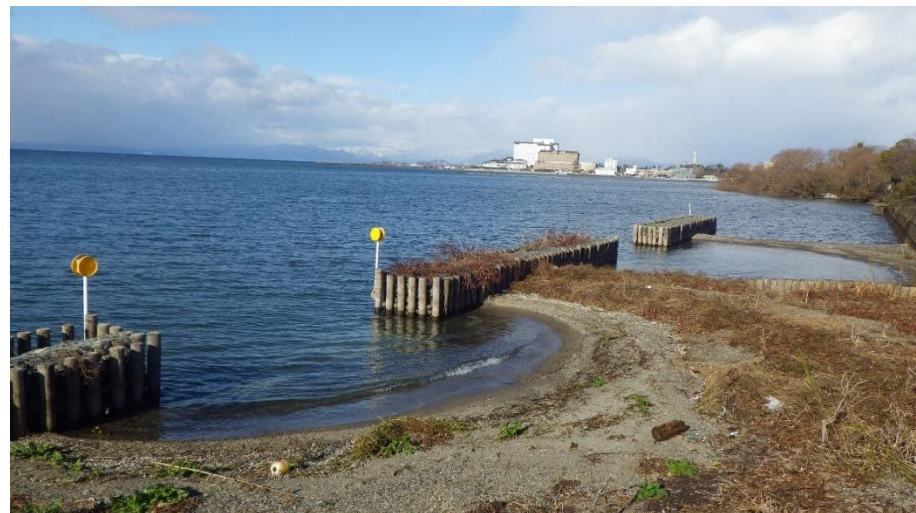
長浜市平方町地先の湖岸におけるヨシ群落造成工事(琵琶湖保全再生課)
