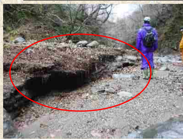
⑧ 大音波谷川溪岸浸食状況
