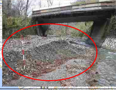
⑩ 高時川との合流地点土砂堆積状況
