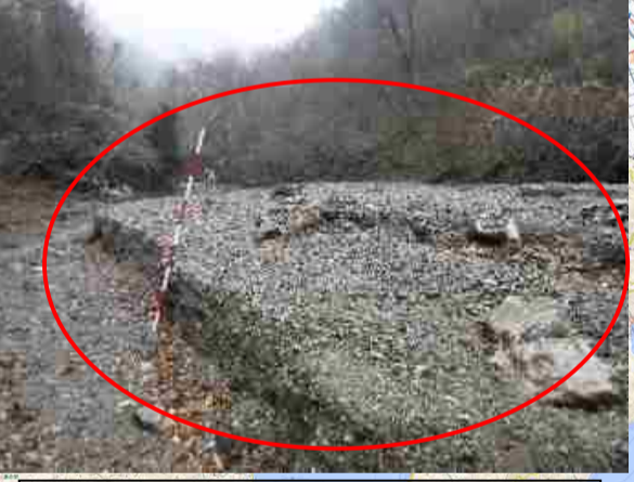
④ 大音波谷川土砂堆積状況
