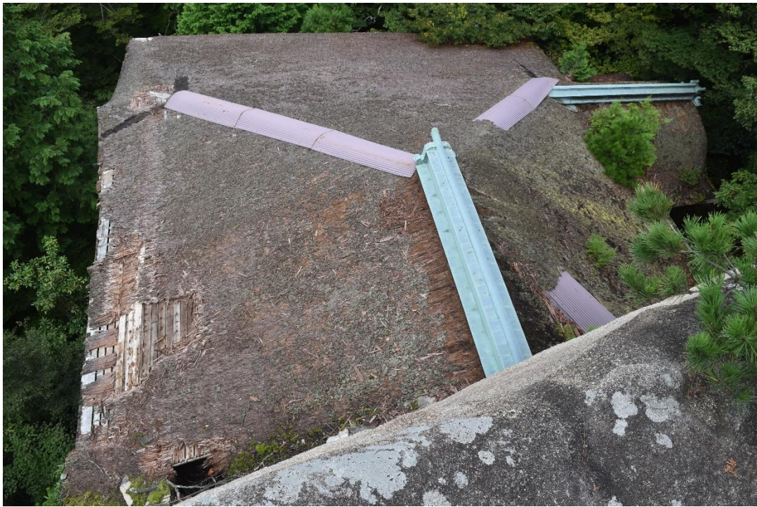
本堂及び礼堂屋根の破損状況
