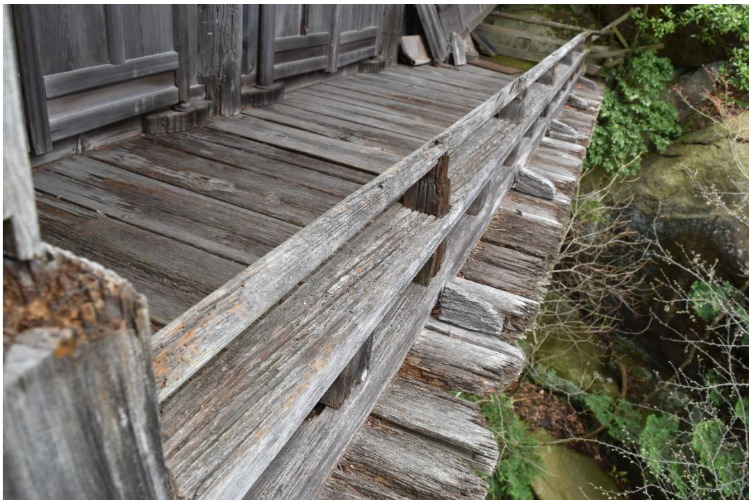
本堂縁廻り（南側）の破損状況
