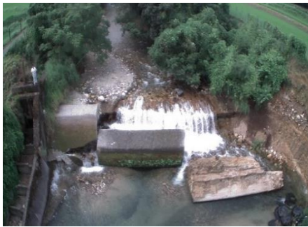
左の大雨により旧農業用水取水堰が崩壊
